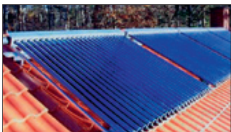
Solfangere med vakuumrør.
