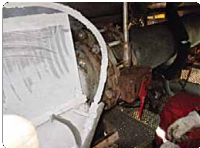
Man kan foretage rørfrysning på stort set alle former for flydende medier.
