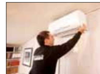
Hva gjør du med varmepumpen når du skal pusse opp?
