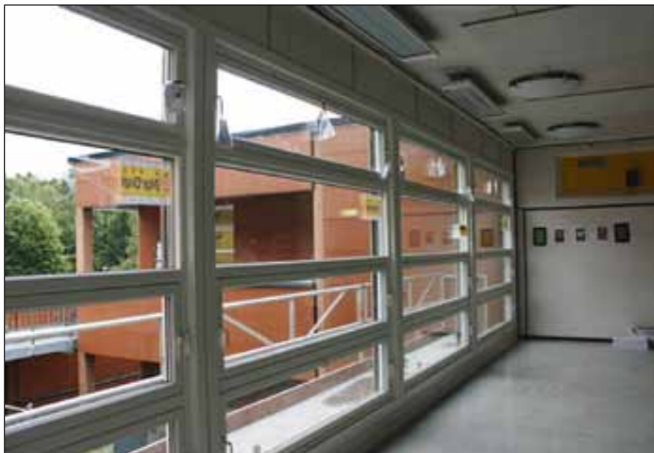
Vinduene fra innsiden. Motorene som styrer systemet plasseres over vinduene.
