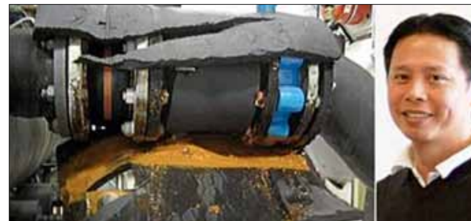
De første synlige tegnene på korrosjonsproblemer i spritanlegg er ofte lekkasje ved stengeventiler. Van Ha Doan i Norkjemi AS orienterte om det på Fagdagene 2012. (Foto: Norkjemi AS)
