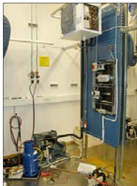
Ett av de 15 eleanleggene.
