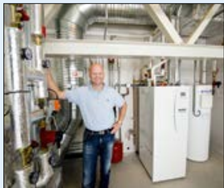
Salgssjef Glenn Wiggo Lystad foran oppvarmingssystemet i bygget.
