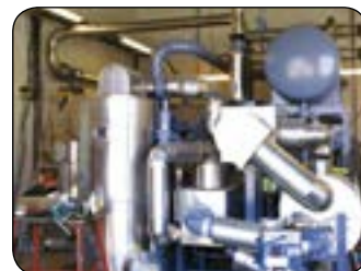
Varmepumpe i fjernvarmeanlegg.
