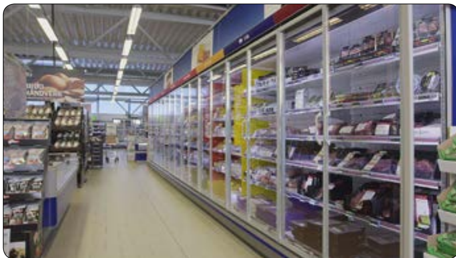
Den grundlæggende idé bag den nye løsning er, at kølesystemet også fungerer som en varmepumpe om vinteren og sørger for køling til klimaanlægget om sommeren.
