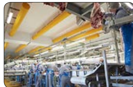
Særligt de støjfrie posekøleanlæg kan risikere at blive overset med uheldige konsekvenser til følge.
