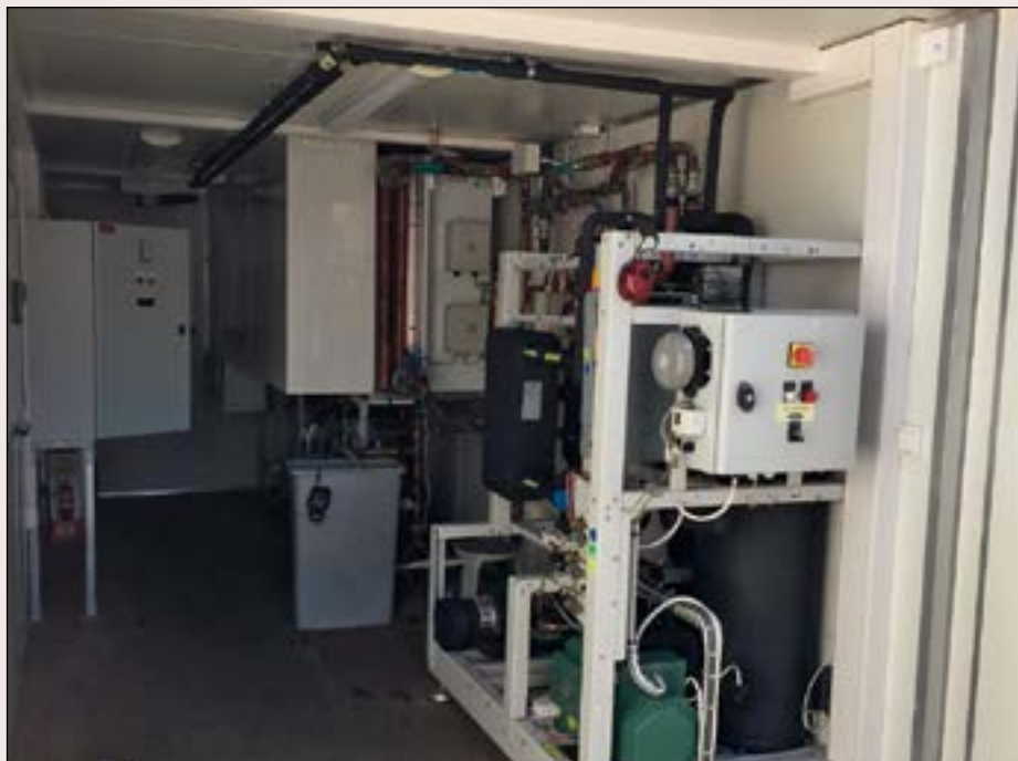
Carrier i Norge har valgt å satse på et eget treningscenter. Her kan først og fremst egne teknikere og samarbeidspartnere ha mulighet til å få gjennomføre «live» opplæring i ulike faser og nivåer av et typisk transkritisk CO 2 anlegg.
