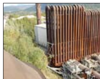
34 Kjøling basert på fjernvarme i Mo i Rana
