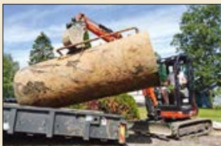
Miljødirektoratet foreslår at alle nedgravde tanker som ikke er i bruk, må tømmes, rengjøres og graves opp eller saneres.
