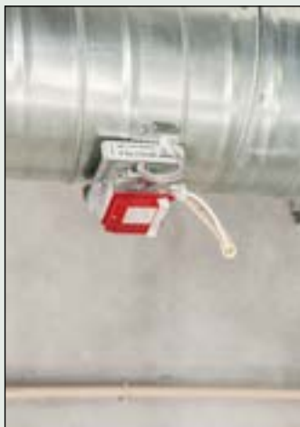
Trykksensor må plasseres riktig for å minimalisere energisløsing i trykkstyrte anlegg. Foto: Hilde Kari Nylund
