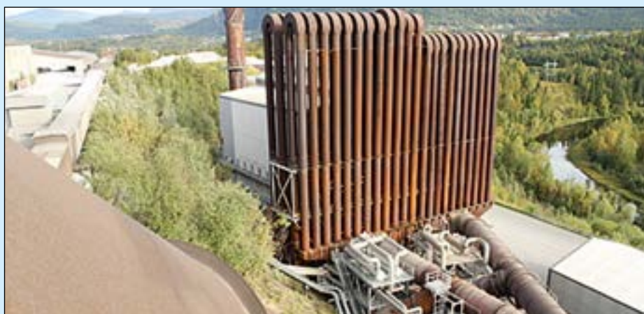
Spillvarmen fra industriparken blir brukt til å kjøle et nytt kontor- og verkstedsbygg i Mo i Rana. Bygget blir ett av de første i Norge med såkalt sorptiv kjøling. (Foto: Mo Industripark)
