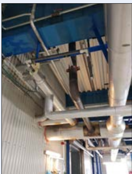
Kuldeanlegg i Lofoten med Haelok rørkoblinger.
