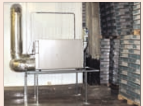
Avfukter i fryselager.
