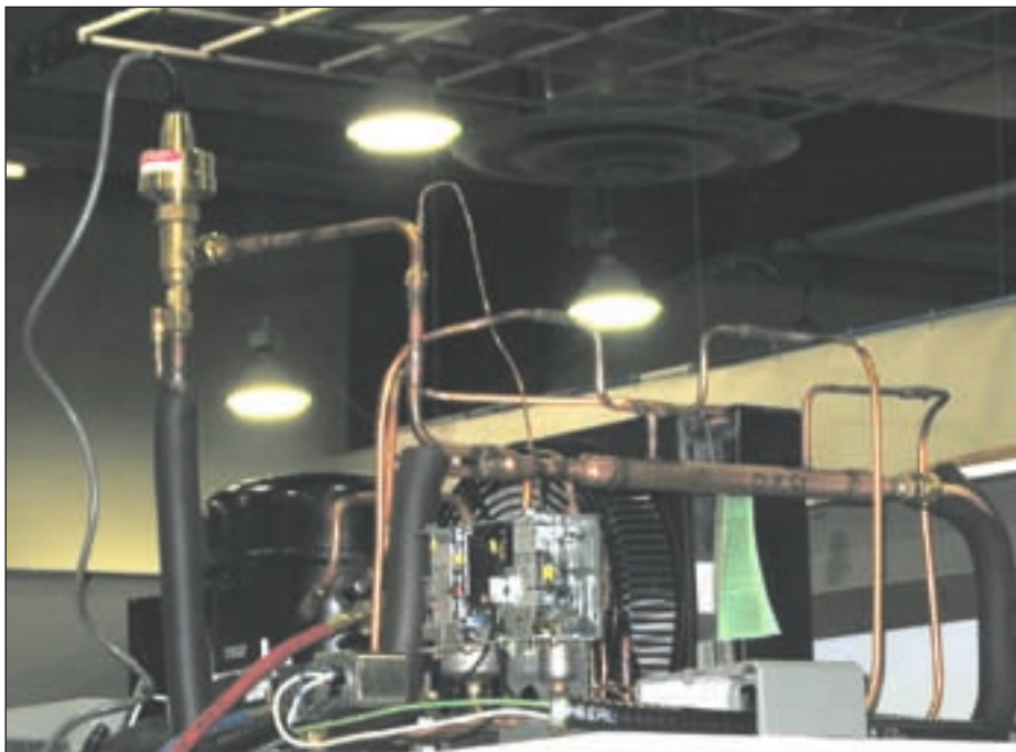
Et eksempel på utført montasje av kjøle-fryseskap.
