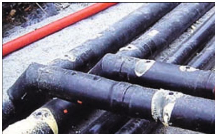
- De som ikke ønsker å knytte seg opp til et fjernvarmeanlegg skal slippe avgifter, sa Audun Brenne fra Trondheim Energi på et møte om fjernvarme i Harstad.
