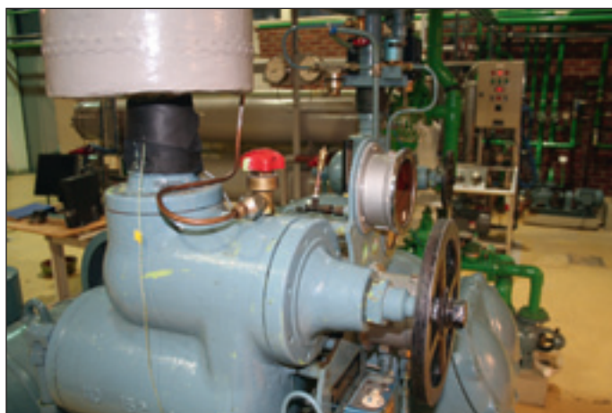
Kjølemaskinistkolen hadde en varmepumpe med ca 300 kg R12 som kuldemedium.
