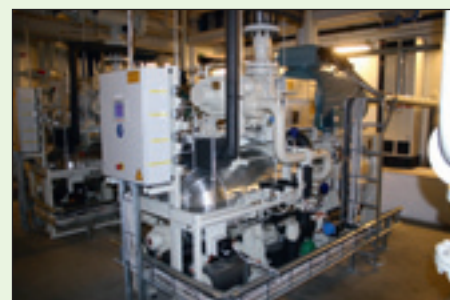
En kompressoroppstilling som er en fryd for øye for enhver kuldemann.
