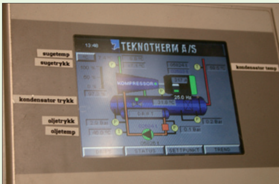
Overvåkningssystemet med norsk tekst utviklet av Therma (Therma Industri tidligere).
