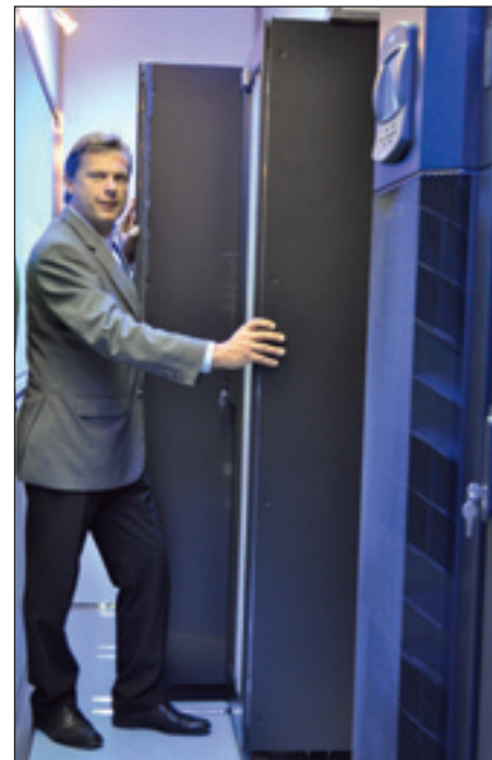
Erik Dahl i Friganor inne i det mobile nøkkelferdige datasenteret med blant annet integrert kjøleanlegg.
