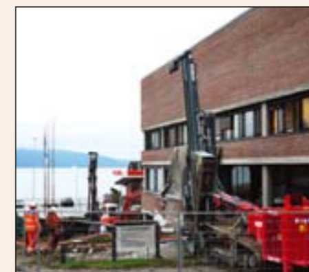
Kjølinga skal skje ved hjelp av fjellbrønner, og det vert no arbeidd med å bore slike rundt fylkeshuset.
