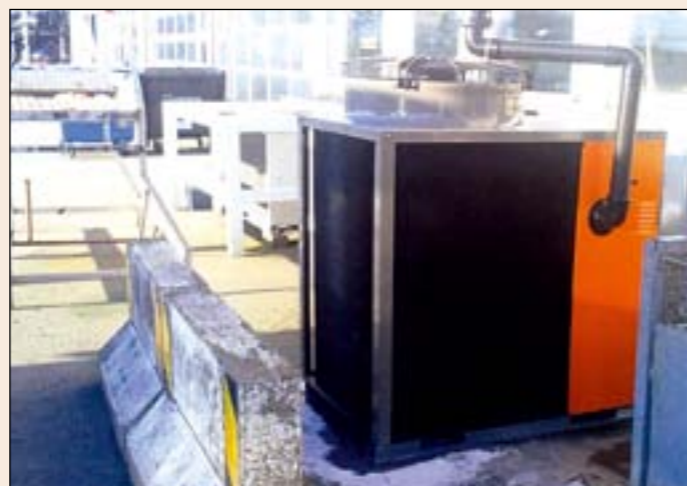
AC Enko installert tidligere i år en gassdrevet varmepumpe fra SGP Varmeteknikk hos Veolia i Rogaland.
