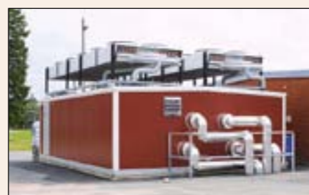
Innregulering og i gang kjøringprosessen er f.eks. svært viktig for kjøleanlegg forkunstbaner.
