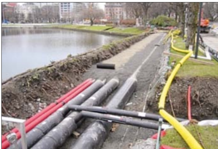
Bellona vil at det skal bli enklere å søke fritak fra tilknytningsplikten i forbindelse med fjernvarme. Illustrasjonsbildet viser legging av fjernvarmerør i Bergen. (Foto: BKK)
