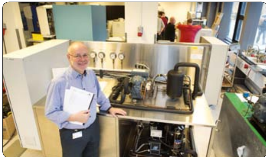
Centerchef Lau Vørs ved Maskinmesterskolen Københavns nye Center for anvendt køleteknik der åbnede 1. December. (Foto Kim Agersten)
