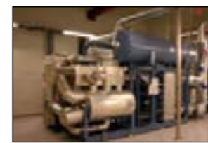
Varmepumpa er på 2 MW med ammoniakk som kuldemediet, ett av få naturlige kuldemedier.
