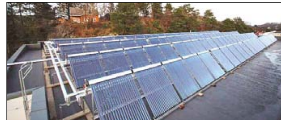
Solfangerne består av 500 m 2 vakuumsolceller som er plassert på taket av Mandalshallen. Egersund-bedriften Nodland Rør AS har montert anlegget. Foto:Nodland Rør AS
