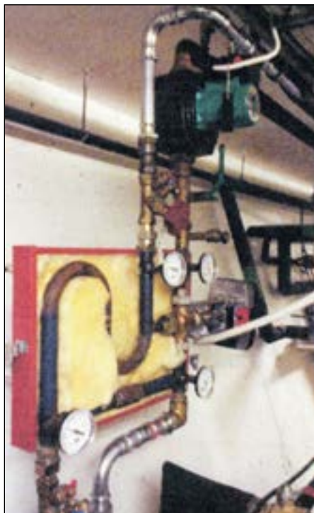
Slik så det ut før arbeidet tok til. Legg merke til de kraftig underdimensjonerte rørene, som hindret tilstrekkelig gjennomstrømming i Krafthallen.
