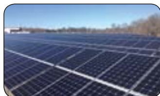
81 Norden største solcelleanlæg.
