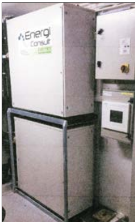
Det nye tekniske rommet med to Panasonic S-500WX2E5 innedeler. Det hvite konsollet til høyre på bildet er Panasonic Intelligent Controller (CZ-256ESMC2). Systemet kan styres herifra, eller også fra en PC.
