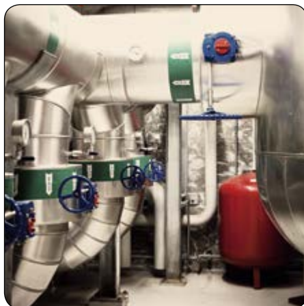
Et moderne fjernkøleanlæg
