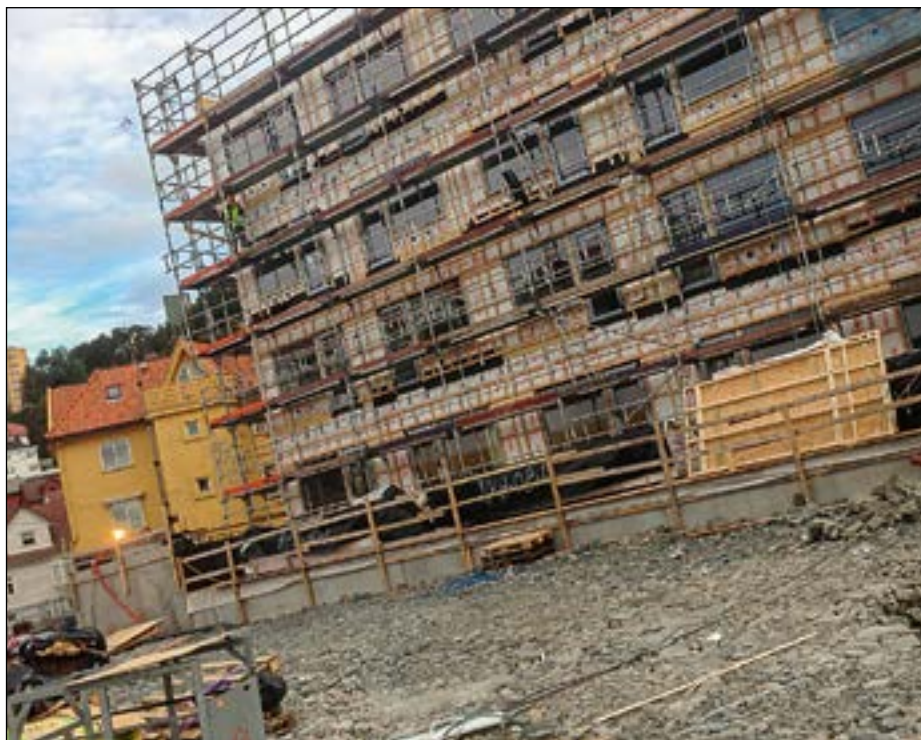
Selvaag Bolig i Bergen har valgt en alt i ett løsning hvor avtrekksvarmepumper kan dekke behovet for ventilasjon, varmtvann og romvarme. En kostnadseffektiv løsning, mener Christian O. Arnesen i ABK AS.
