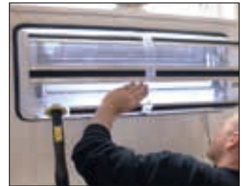
32 Rengjøring av luft-luft varmepumper
