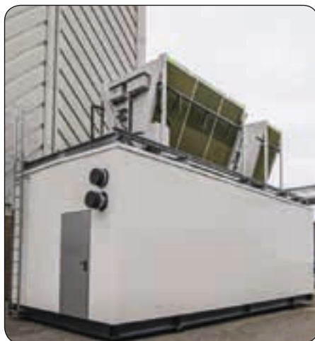
Udfordringen ved anlægget er, at det er opbygget i fire store «containere», på 16 tonn som er ophængt i bygningens tagkonstruktion – 25 meter over jorden.
