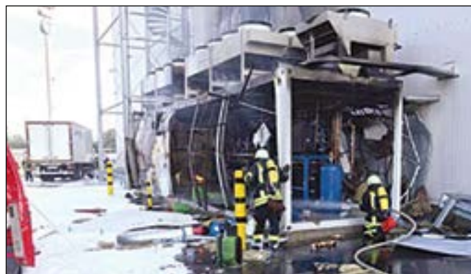
Propaneksplosjon i et aggregat under servicearbeider Seks personer ble skadet hvorav to fikk alvorlige brannskader.
