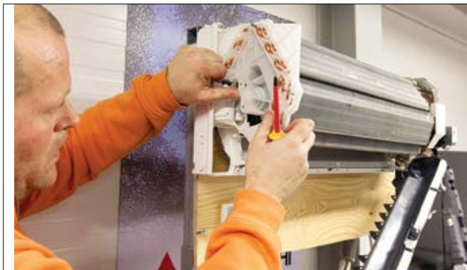
Man bør ha service på luft-luft varmepumpen hvert annet til hvert tredje år. Og det er viktig for å rengjøre filterne på innedelen i mellomtiden.
