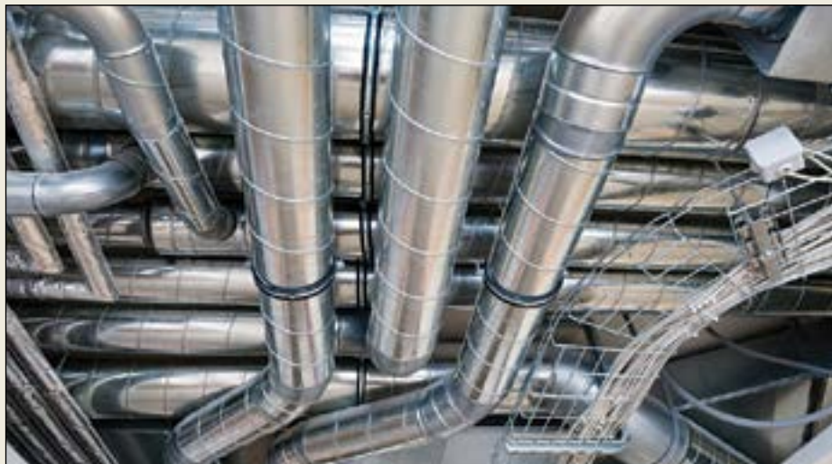
Også faste himlinger har samme problemstilling. Etter manges syn bør det tilstrebes tilgjengelighet til alle tekniske installasjoner.
