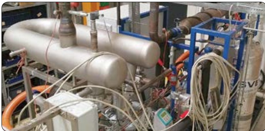
Nyt fordampersystem forener de gode egenskaber fra direkte ekspansion (DX) og oversvømmet system (flooded), og anvender ammoniak som kølemiddel. Ved at gøre dette bliver ulemperne ved de to systemer undgået.
