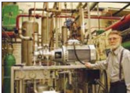
Professor Einar Brendeng har utviklet små kondensasjonsanlegg for naturgass basert på standardutstyr. Her var han i gang i laboratoriet med innkjøringen av det nytvinklede kondensasjonsanlegget.
